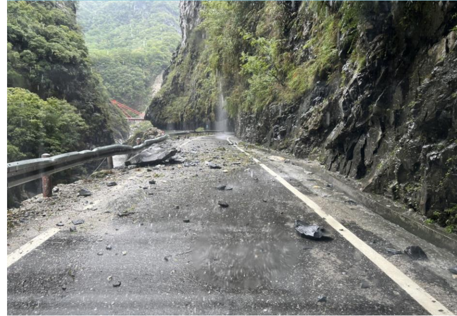
邊坡雨瀑、護欄扭曲變形及路面刮痕
